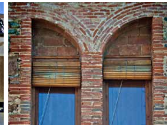
L'obra inacabada permet veure com es construeixen els arcs oposats de quart de punt del primer pis, a base de diverses capes de maó català posat pla.
